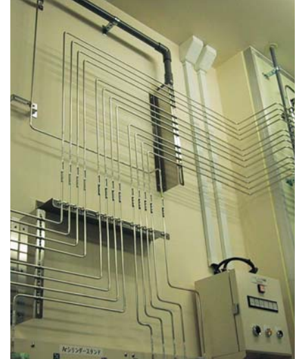
分析室内高純度配管
